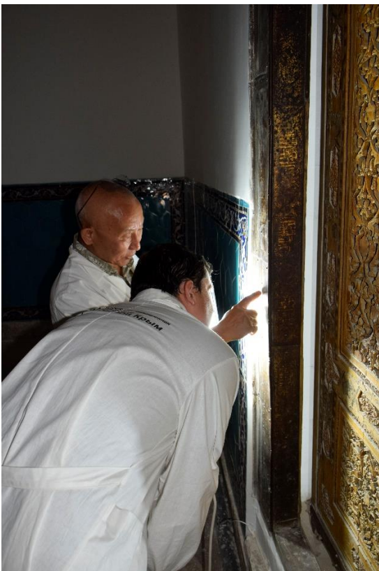
Рисунок 3. Натурное обследование состояния двери, 2018.
